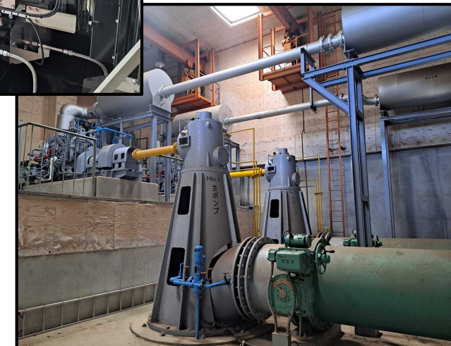
古戸排水機場場内
