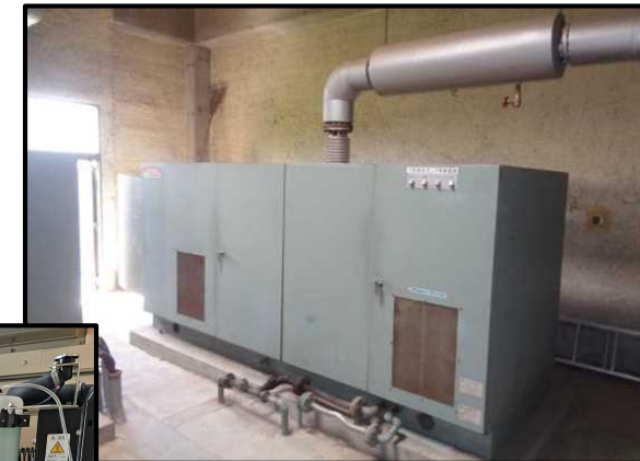
添排水機場自家発電機
