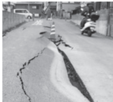
地震による道路破損（井野台）
