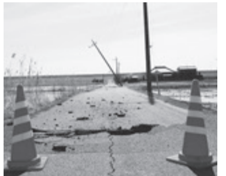
地震による道路破損と液状化（大留）
