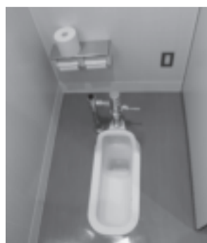
フラッシュバルブ式トイレ
