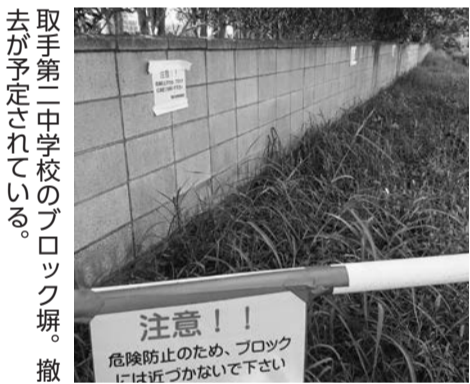
取手第二中学校のブロック塀。撤去が予定されている。
