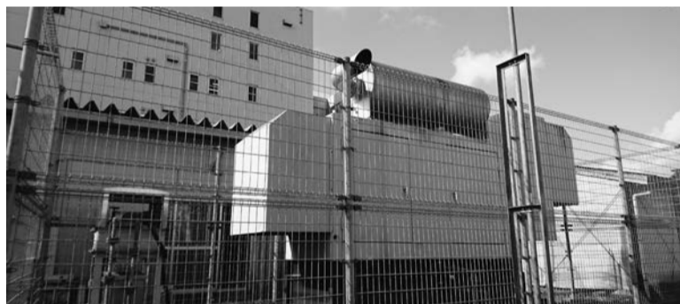
庁舎に設置されている自家発電機。賄える範囲を拡大する設計へ。
