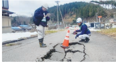
至る所に確認された道路の陥没
