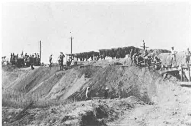
鉄道連隊の作業光景②(佐藤宗一氏所蔵) 利根川寄りに貨車で運んだ土をまたトロッコに積み替えて、堤防に沿って土を積み上げています。木橋は、常磐線の鉄橋の下流側に作るように計画されていたようです。
