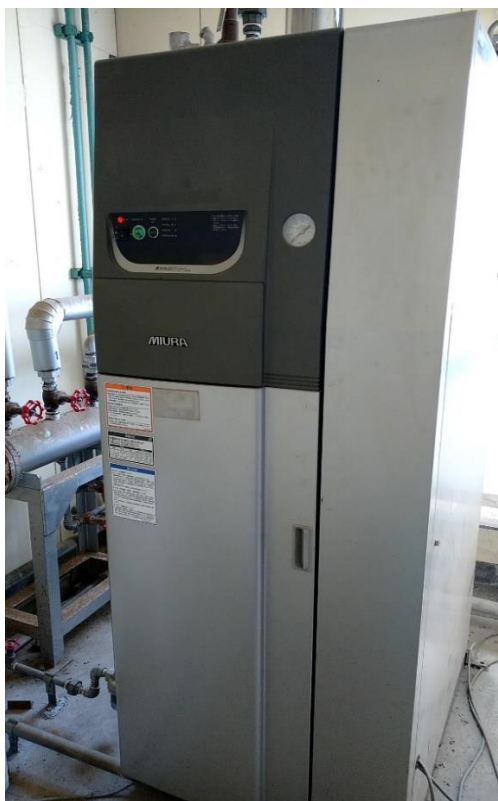
蒸気ボイラー
