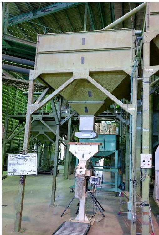
秤量タンク及び計量機
