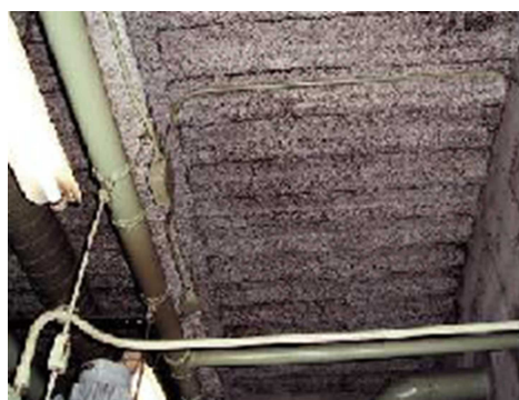
石綿含有吹付けロックウール
